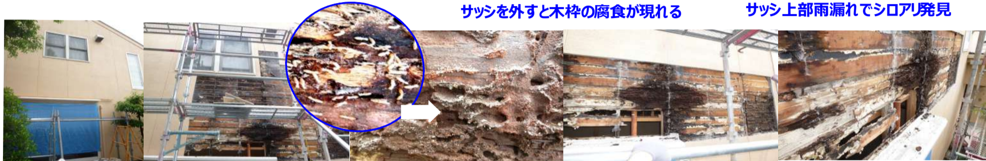
サッシまわりの外壁を剥がすと大量のシロアリ発見
