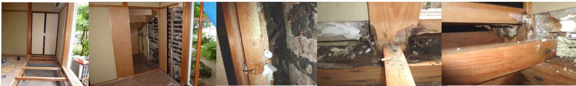
サッシを外すと木枠の腐食が現れる
